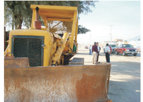
Trabajos de asfalto y construcción de machuelos en Av. Carlos Páez Stille
