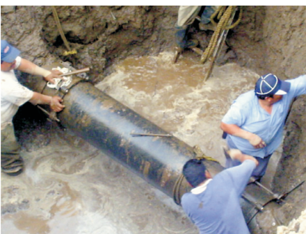
Línea de conducción del Pozo No. 24
