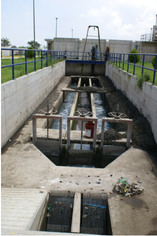
Tratamiento de aguas residuales
